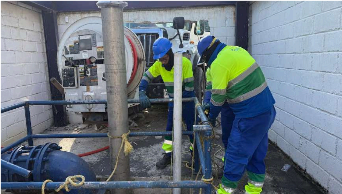
Cortesía Estación de bombeo.
