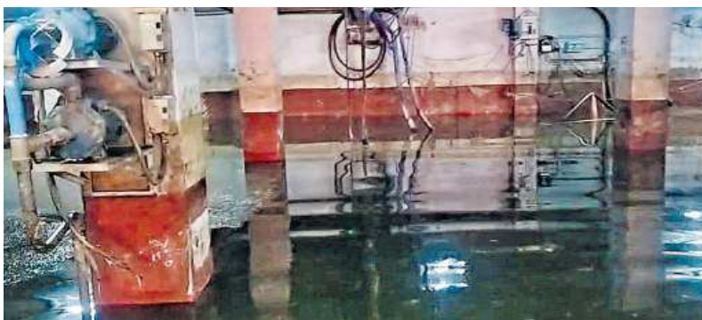
Este es el aspecto que ofrecía ayer el interior del garaje cuando quedaba todavía mucha agua con fecales.
