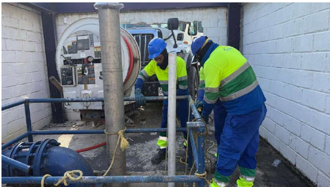
Cortesía Estación de bombeo.
